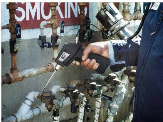
Teste purgadores de vapor
