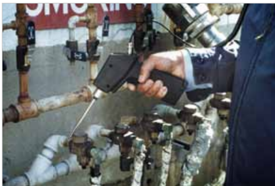
Inspektion von Kondensatabscheidern
